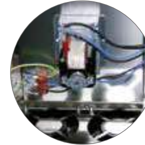
Ventilation des moteurs / Motors ventilation
